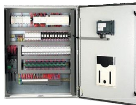
ШУ шкаф управления
